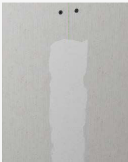
Teilweise vorgenommene Fugenspachtelung
