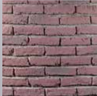
LADRILLO ADOBE verwittert kalkig – ca. 1040x834 mm
